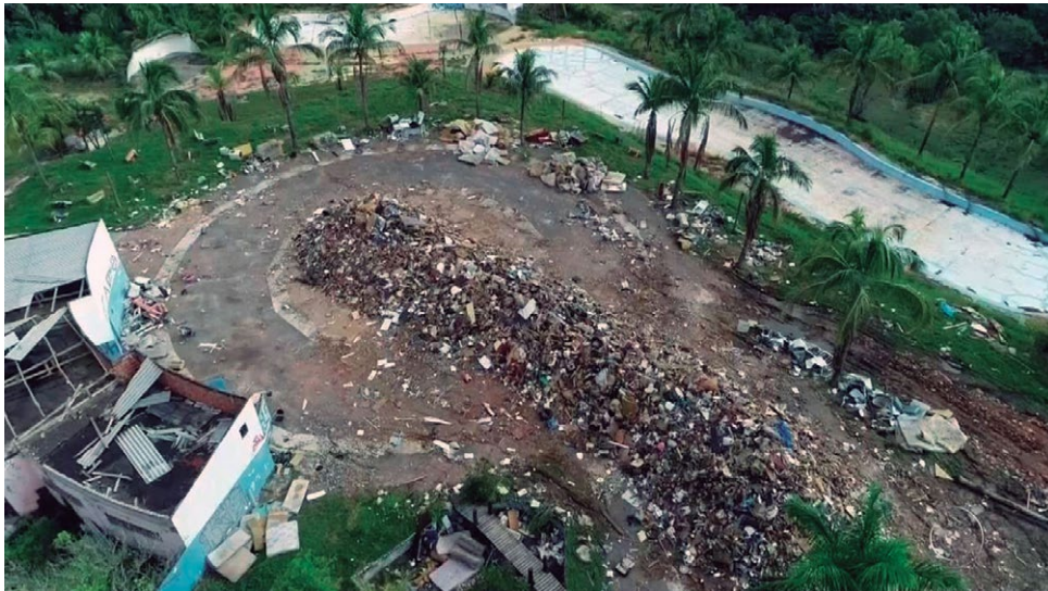
Parque Aquático de Marília, que custou mais de R$ 2 milhões de reais e hoje está entregue ao abandono, se transformando em um depósito de lixo.
